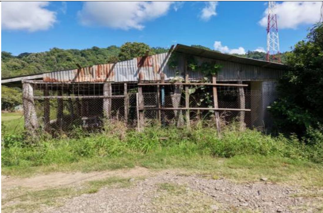
Imagen 2. Se muestra la fachada lateral y la vista en planta del Salón Comunal de San Rafael antes y después de la ejecución.
