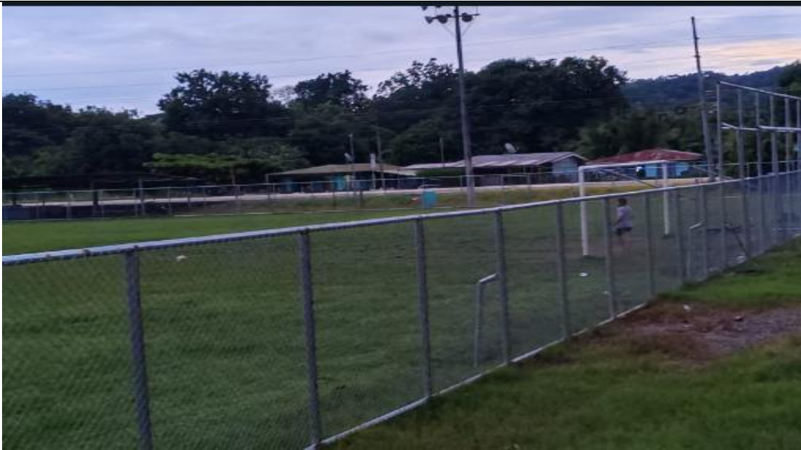
Imagen 3. Se muestra parte del proceso de los trabajos de la malla, como está concluida en la Plaza de deportes de Rio Grande de Paquera
